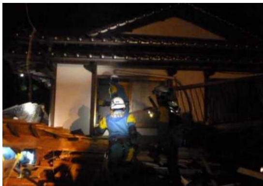
図 2-3-20 2階の窓から要救助者にアプローチする際の状況（一例） （出典：参考文献 13）
