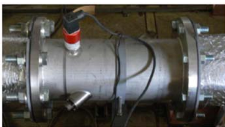
写真 2-8 超音波流量計の外観
