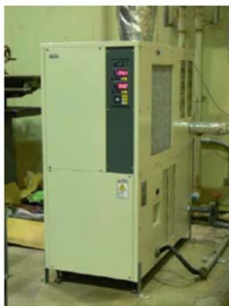
写真 2-6 空調機の概観
