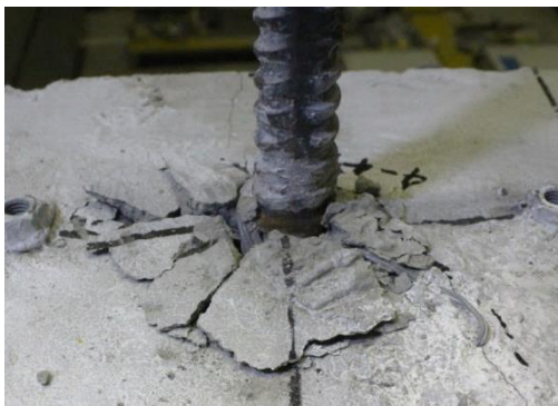
写真 5.2.1 アンカー筋周囲の破壊状況
