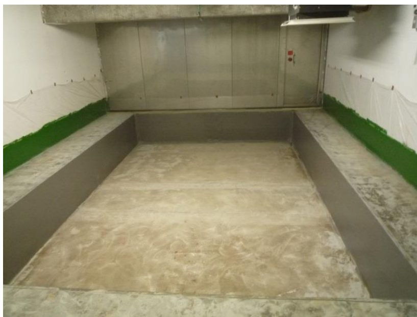
写真3.1 コンクリート養生槽 (4.80m×3.25m×0.65m)
