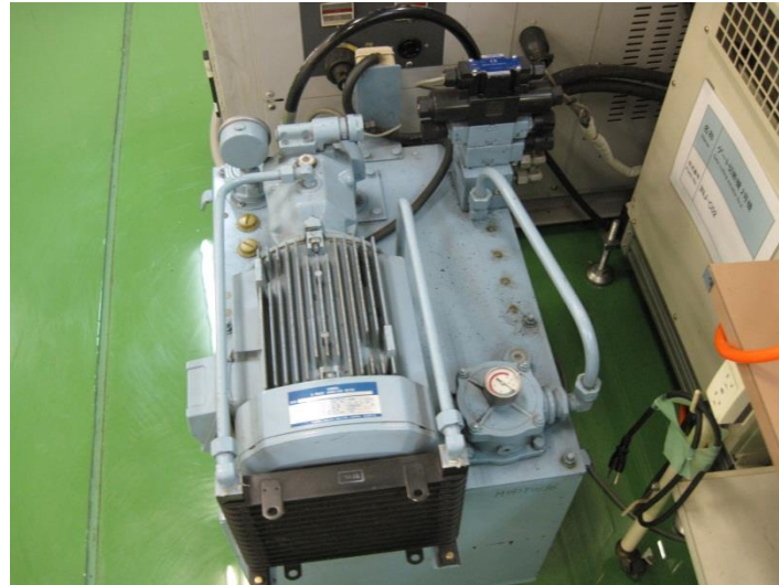
図 2-12 油圧ユニット
